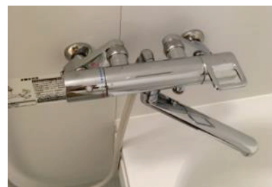
写真Ⅱ.28 サーモスタッド付の給湯用カラン
