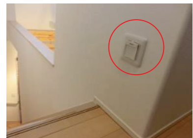
写真Ⅱ.22 階段の段差位置を確認できる場所に 設置された足元灯
