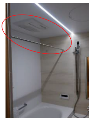
写真Ⅱ.33 浴室の換気暖房乾燥機と 吊り下げ式物干し
