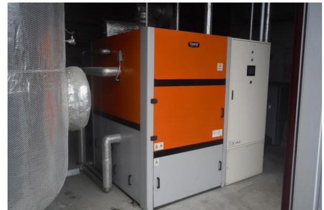
温泉施設ボイラー (あわら市)
