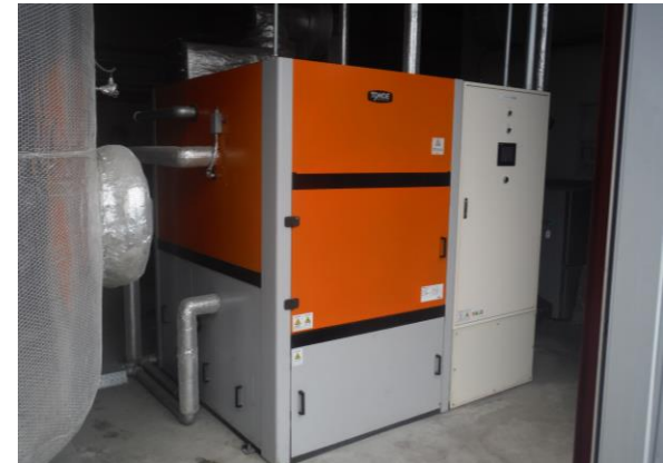
温泉施設ボイラー (あわら市)
