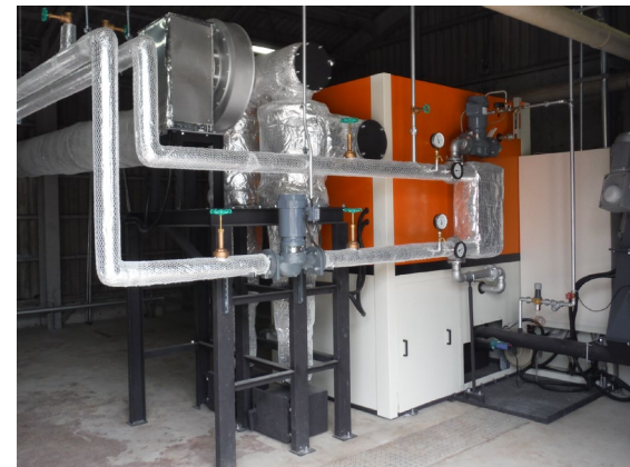
温泉施設ボイラー (あわら市)
