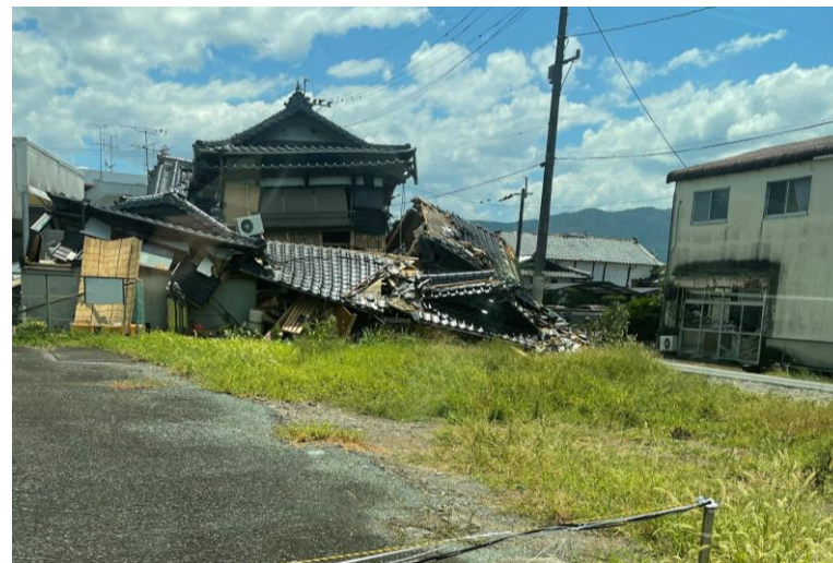
家屋の倒壊(氷川町)
