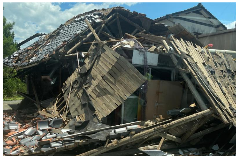
家屋の倒壊(氷川町)
