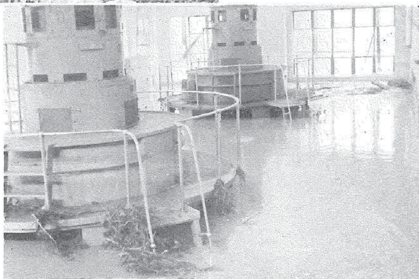
濁流で荒された 発電機室
