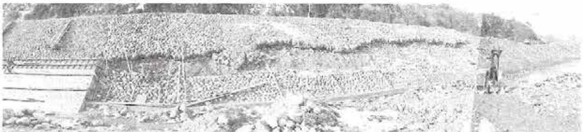
大災害を受けた各個所は着々と復旧工事が進められている
