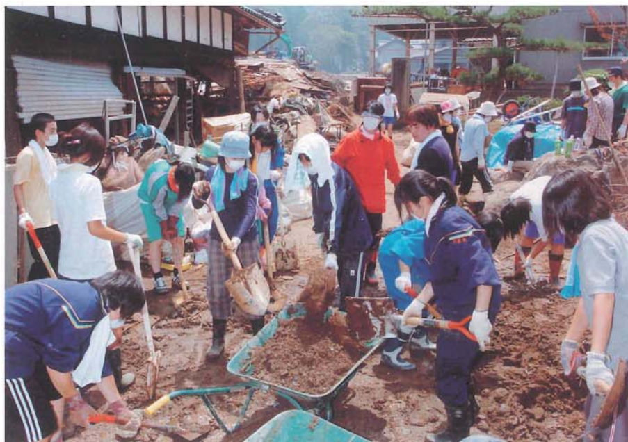
写真-5.11 ボランティアによる汚泥の除去作業（福井市浄土寺町）（福井新聞社提供）
