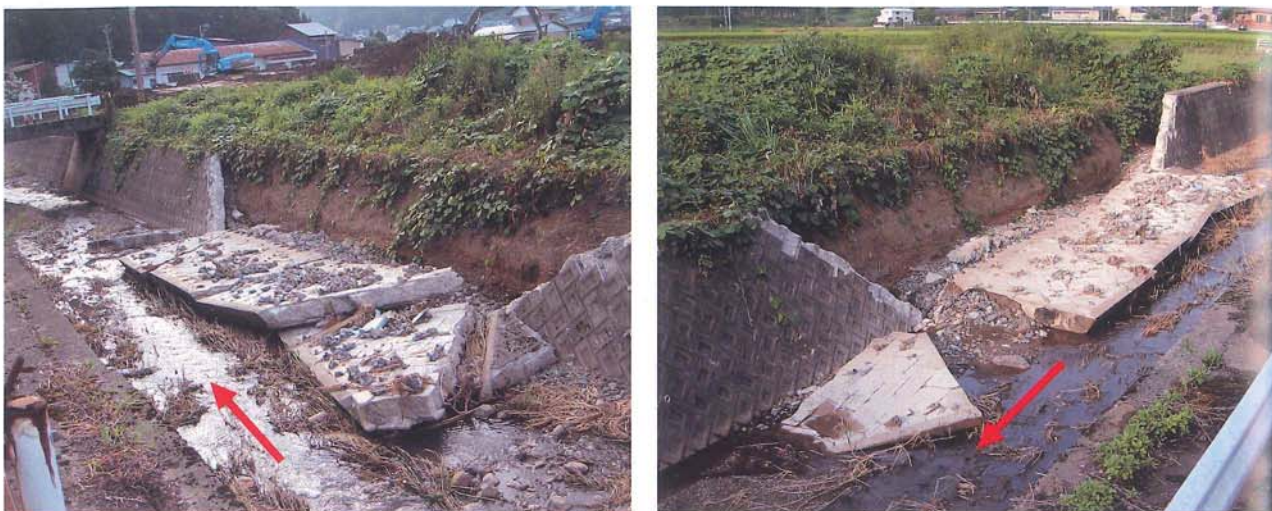
写真-6.13 被災状況
