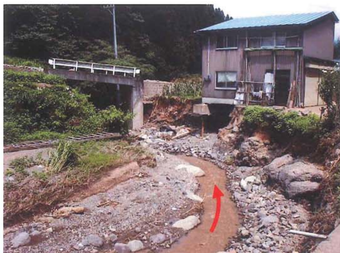
写真-6.11 被災状況
