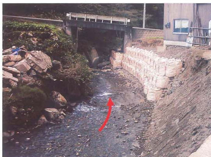
写真-6.12 災害仮復旧状況
