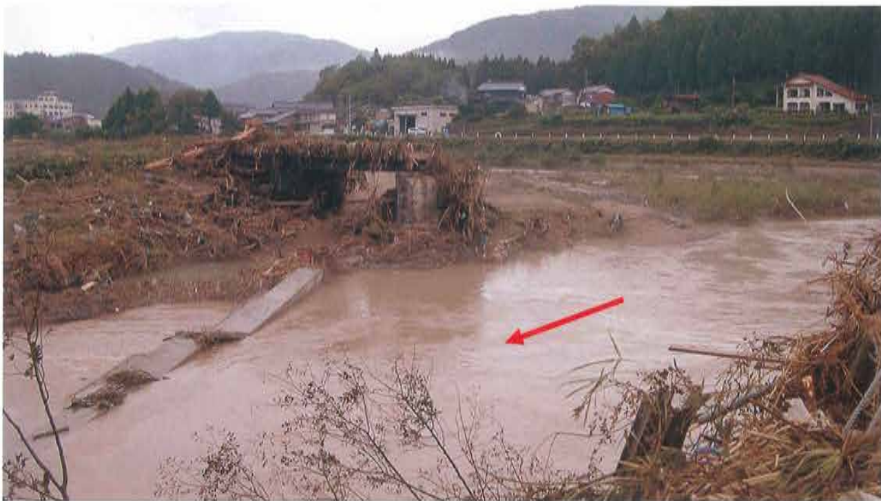
写真-2.16 落橋（田尻新橋 美山町田尻）
