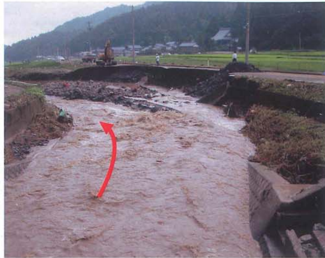
写真-6.21 被災状況
