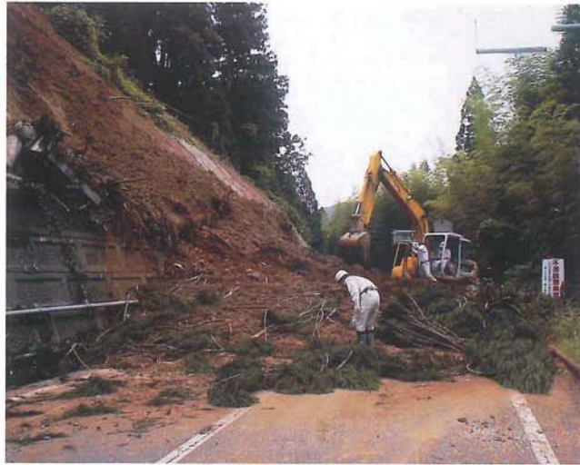
写真-6.19 被災状況
