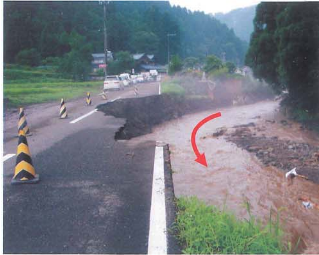
写真-6.23 被災状況
