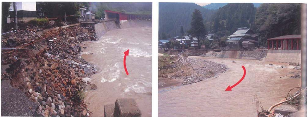
写真-6.17 被災状況
