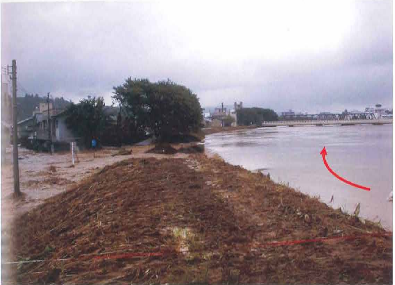
写真-2.7 足羽川の決壊状況（福井市春日1丁目付近）
