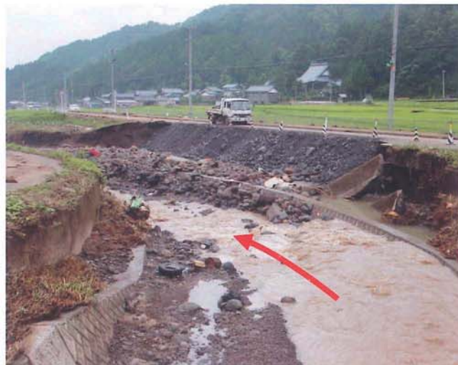
写真-6.22 災害仮復旧状況
