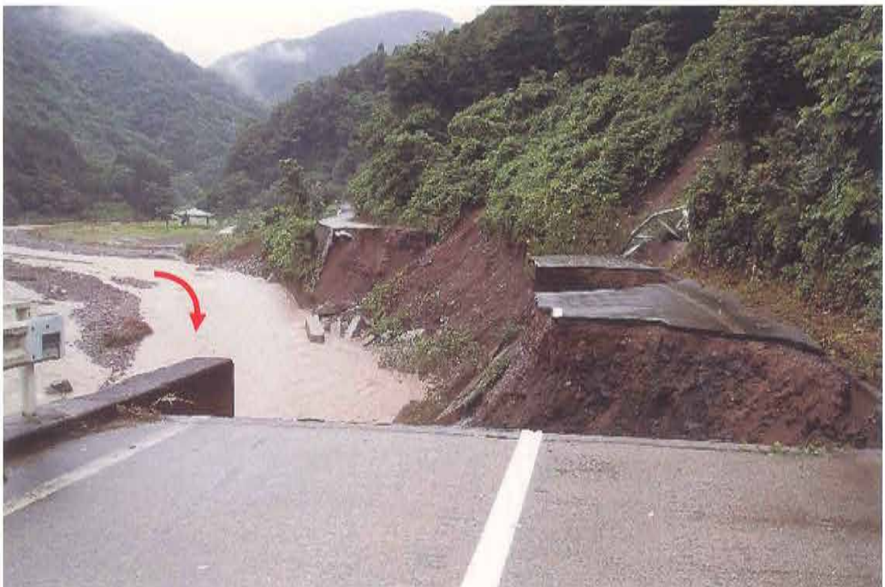
写真-2.13 道路の流失(国道157号-大野市中島)
