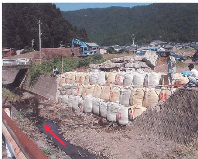
写真-6.14 災害仮復旧状況
