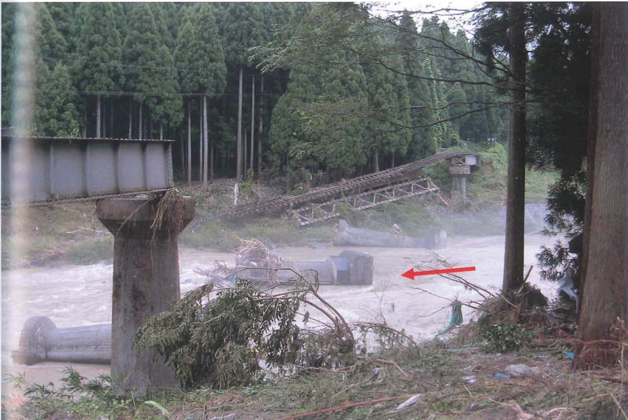
写真-2.18 JR西日本越美北線第3橋梁の落橋(美山町高田)
