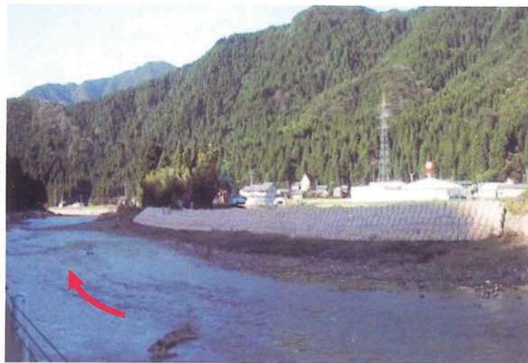
写真-6.10 災害仮復旧状況
