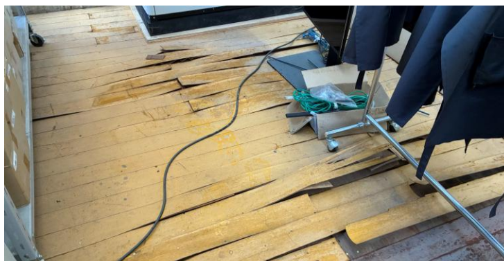
浸水による工場内の床損傷
