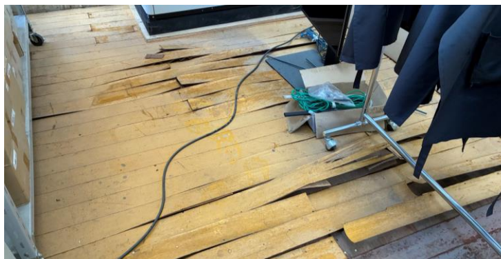
浸水による工場内の床損傷
