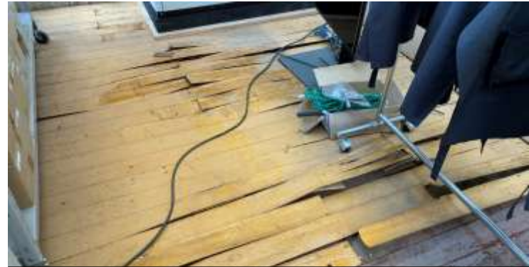
浸水による工場内の床損傷
