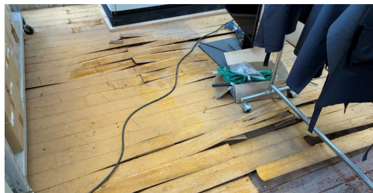
浸水による工場内の床損傷
