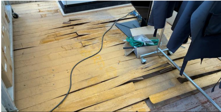
浸水による工場内の床損傷
