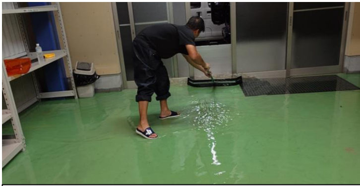
工場内への浸水
