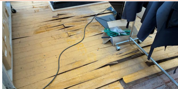
浸水による工場内の床損傷
