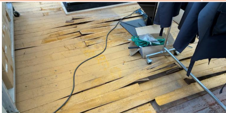
浸水による工場内の床損傷
