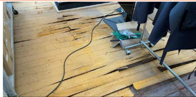
浸水による工場内の床損傷
