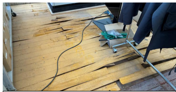
浸水による工場内の床損傷
