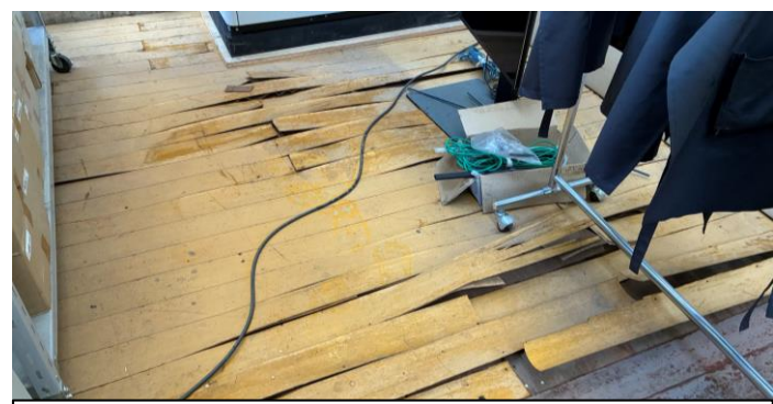
浸水による工場内の床損傷
