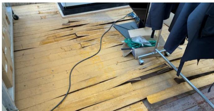
浸水による工場内の床損傷
