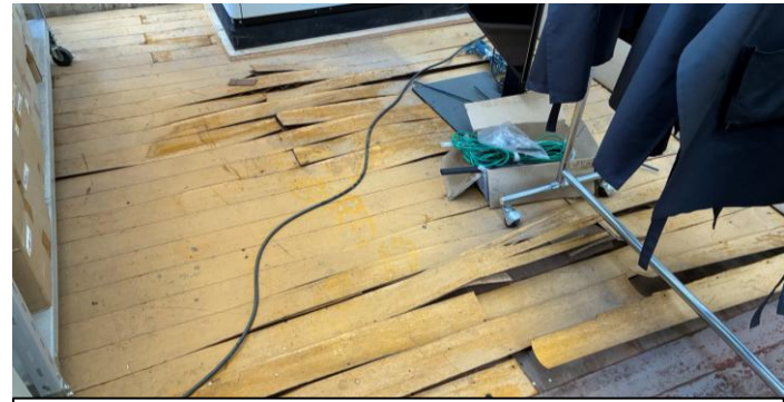
浸水による工場内の床損傷
