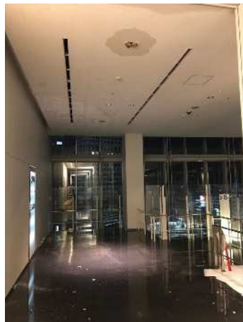
8階の出水箇所
