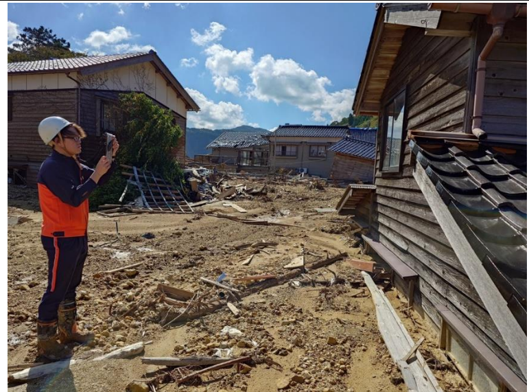
10/13 被害家屋調査
