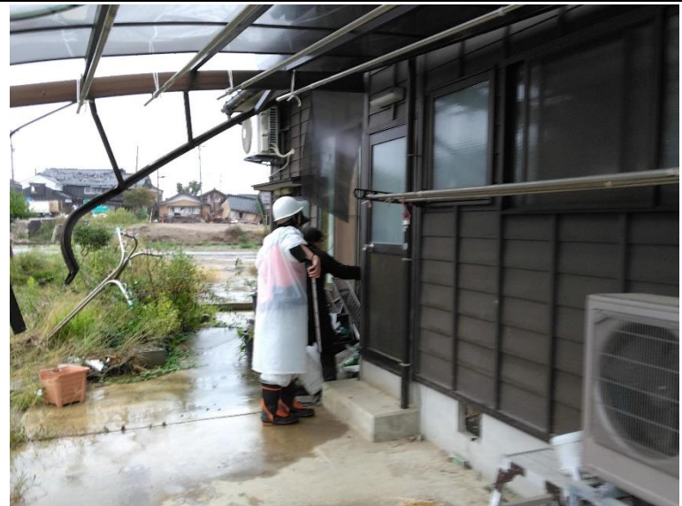
10/7 被害家屋調査
