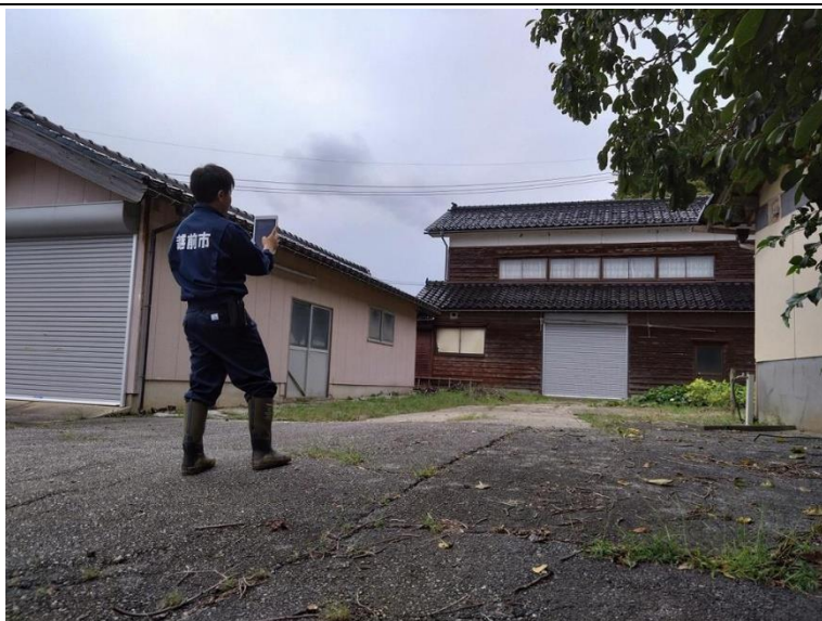
10/8 被害家屋調査
