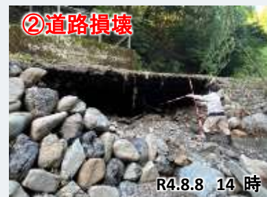
③道路損壊
