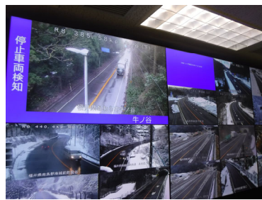
道路情報室モニターアラート状況
