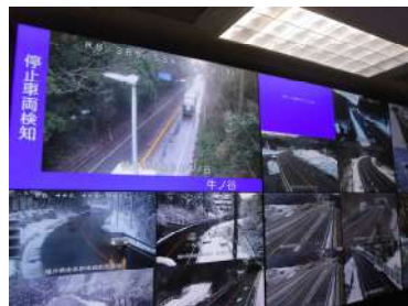
道路情報室モニターアラート状況
