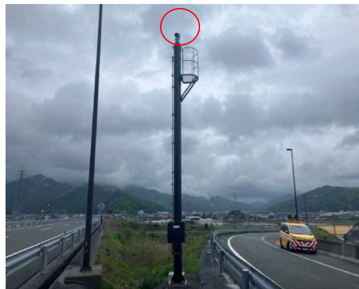
監視カメラ設置状況
