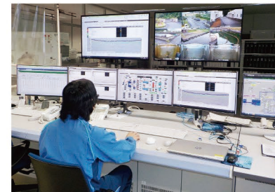
中央監視制御室
