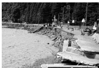
被災した土木施設
