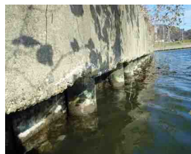
老朽化した貯木場の護岸の状況
