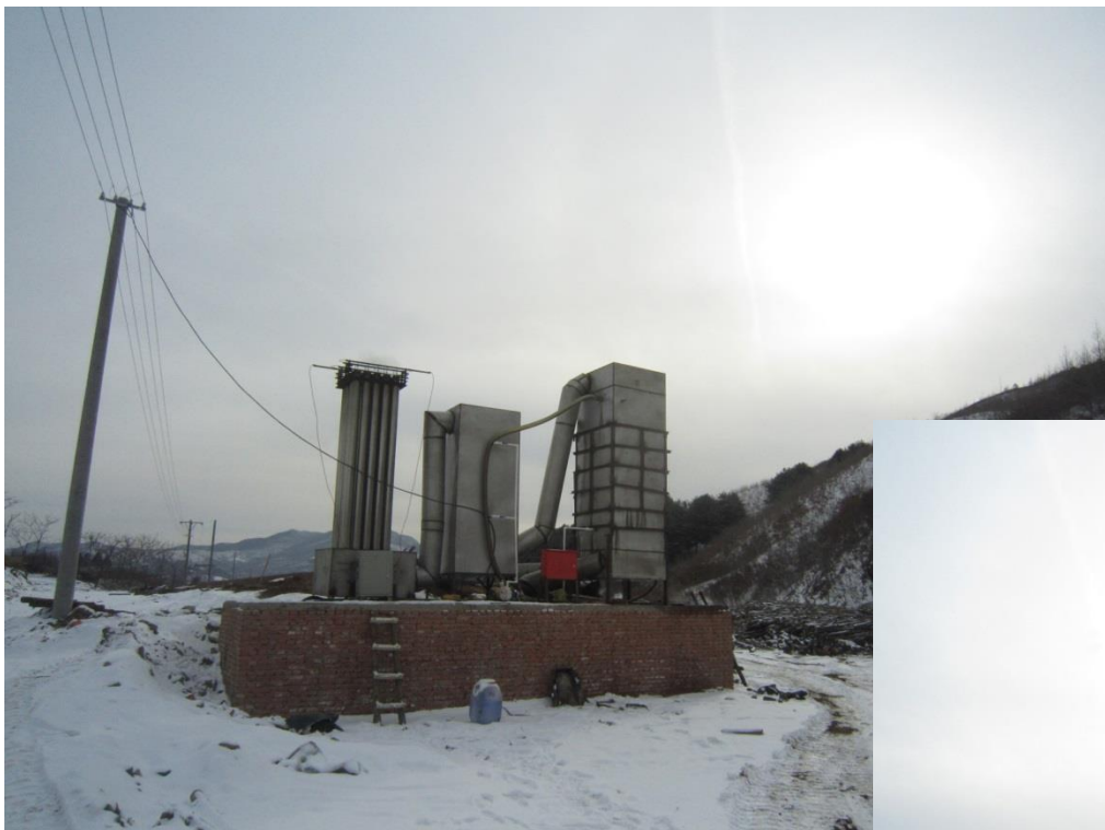
排煙の冷却槽、除塵機
