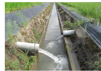
田んぼダム用「排水柵」の設置圃場 （右）と設置していない圃場（左） （水田で雨水を貯留し、下流の水害 リスクを低減）
