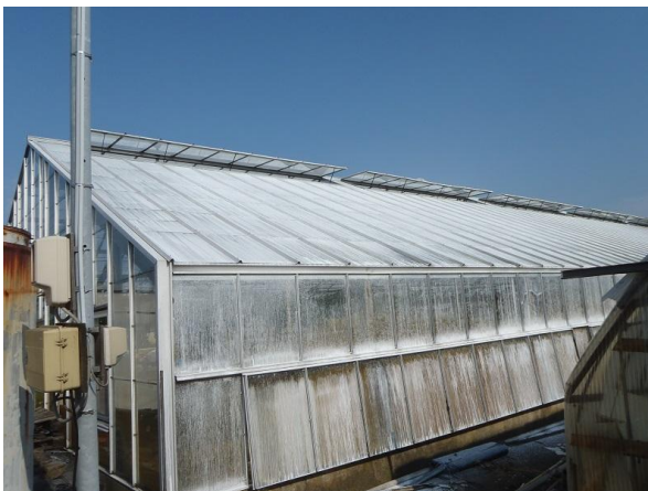
写真1 遮光剤を塗布したガラスハウス
