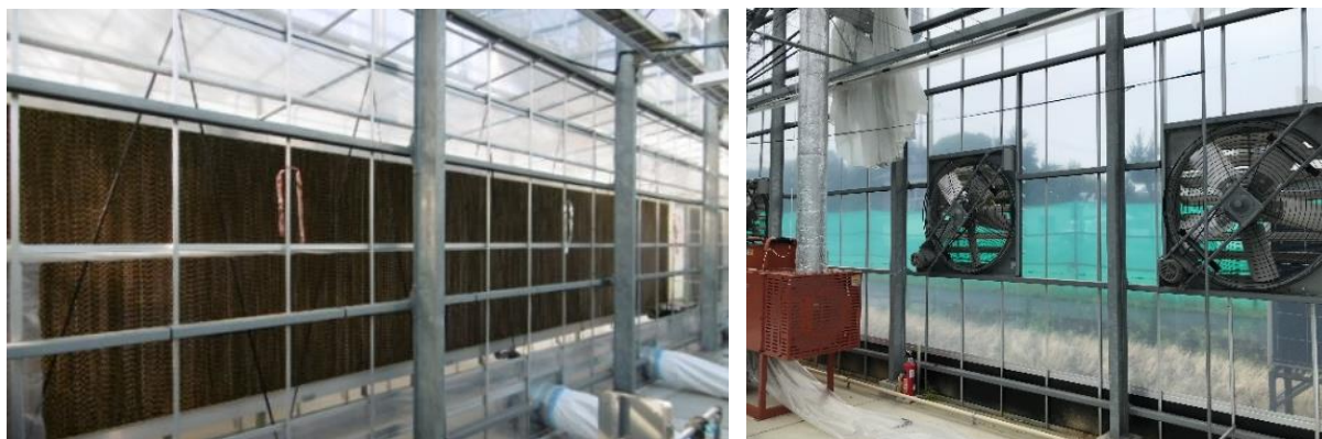
図 1.1 園芸研究センターに設置の有圧ファン併用型パット&ファン
