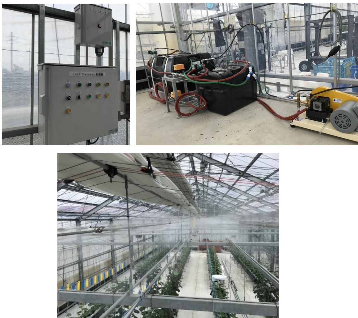
園芸研究センターに設置の細霧冷房装置（CoolPescon（株）いけうち製） 左上：制御盤 右上：コンプレッサー、水タンク等周辺機器、下：噴霧の様子
