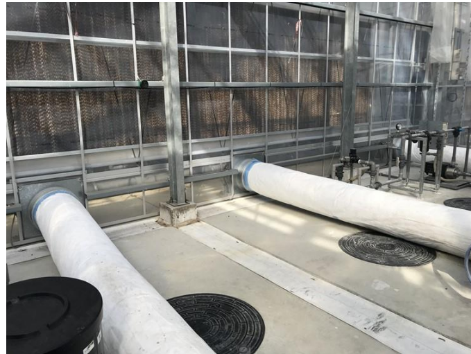
図 1.2 有圧ファンダクトによる送風
