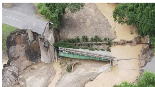
落橋 (鹿蒜(加ル)川)
