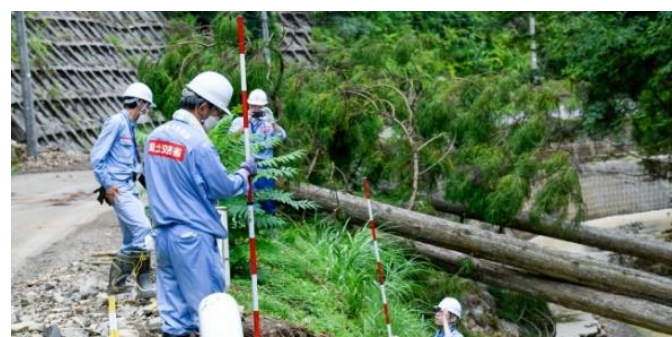
TEC-FORCEによる被災調査 (南越前町)
