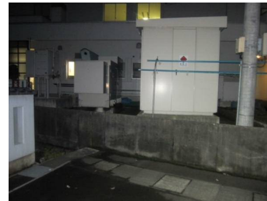
受電設備、非常用発電設備を浸水対策のため、周辺より高い位置に設置(南越前町)
