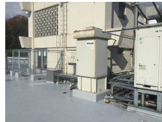
非常用発電設備を浸水対策のため、屋上に設置(鯖江市)
