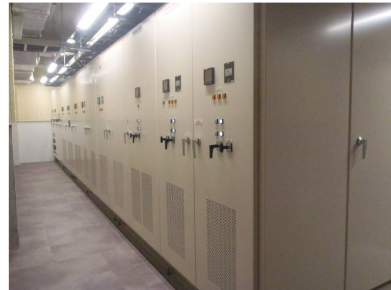
浸水対策のため、庁舎3階に設置した受電設備(高浜町)
