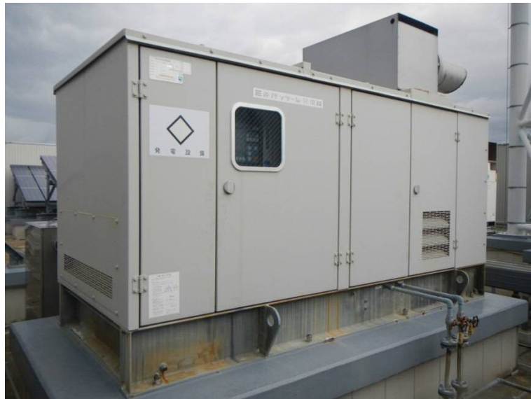
浸水対策のため、庁舎屋上に設置した非常用発電設備(敦賀市)
