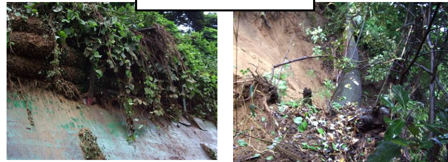
土砂捕捉状況
