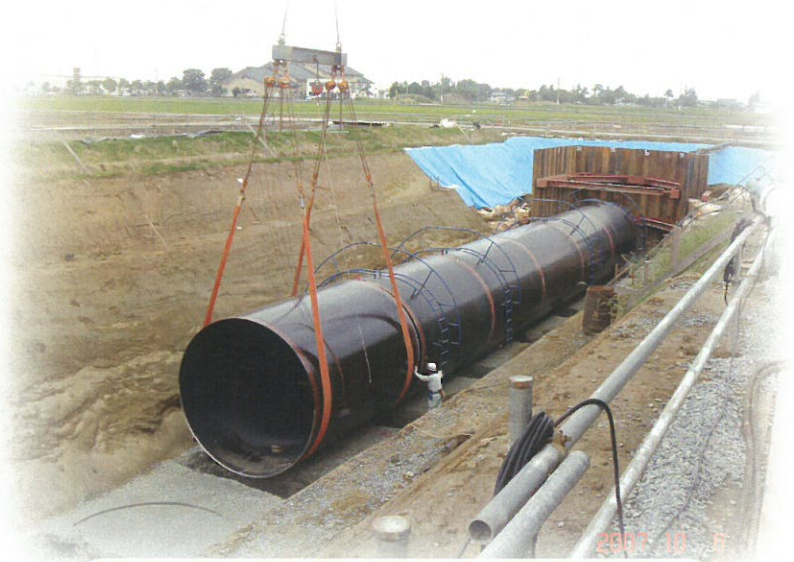
国営パイプライン
