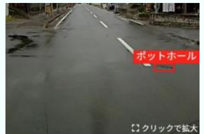
道路損傷箇所の検知
