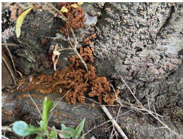
現地確認で見られたフラス
