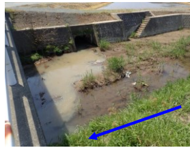
代掻き後の濁水流入の様子
