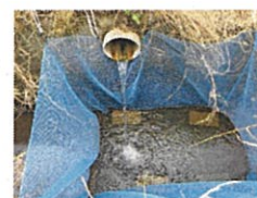
排水口に網設置（中干し時）
