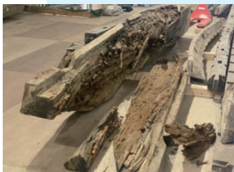
破損している部材
