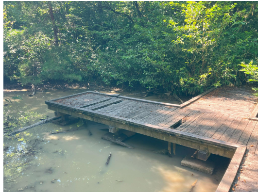
経年により劣化が見られる園路や木橋
