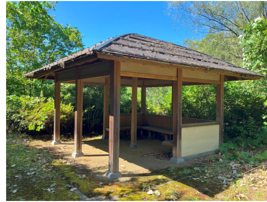
老朽化が進行している園内施設
