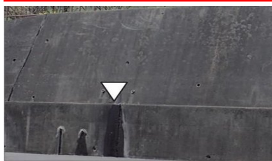
地下水の流出
