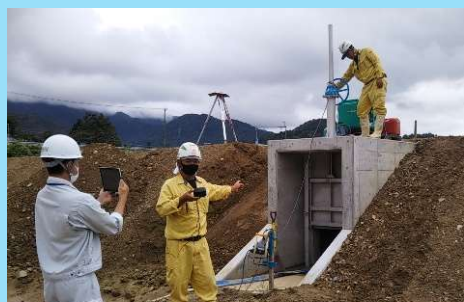
リモートによる現地説明状況
