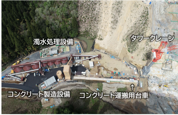
ダム用仮設備
