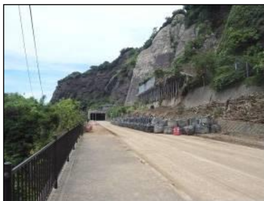
平成30年7月豪雨被災後の状況を確認 (丹生郡越前町玉川地籍)
