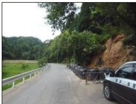
平成30年7月豪雨被災後の状況を確認 (丹生郡越前町山中地籍)
