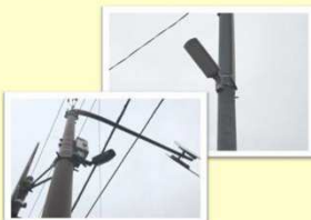
<設置された防犯カメラ(左)と街灯(右) (H31.2)>
