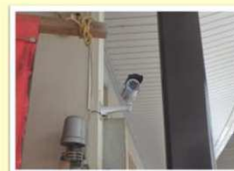
<商店街に設置された防犯カメラ(H31.2)>
