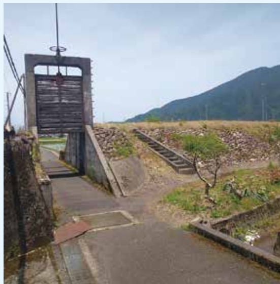
「道にある水門」
